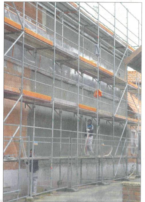
Der Putz kommt an die Mauer: Doch das Gros der Arbeiten findet derzeit im Gebäudeinnern statt.
